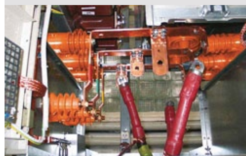
Фронтальное подключение силового кабеля
