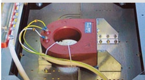
Трансформатор тока нулевой последовательности
