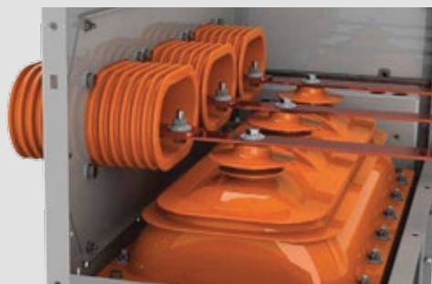
Отсек сборных шин
