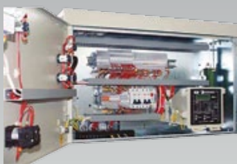
Отсек релейной защиты
